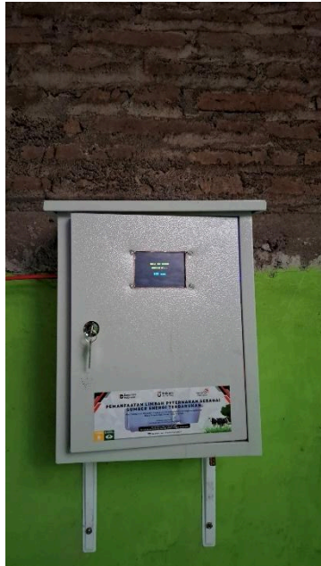
Panel box monitoring sudah terpasang dilokasi biodigester
